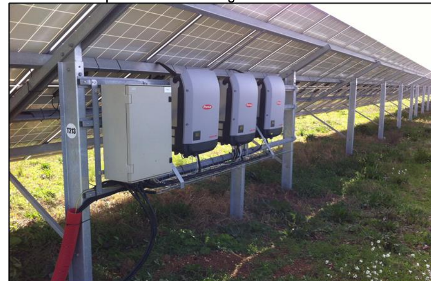
Illustration 18 : Exemple d'onduleurs strings fixés à l'arrière des tables de modules
