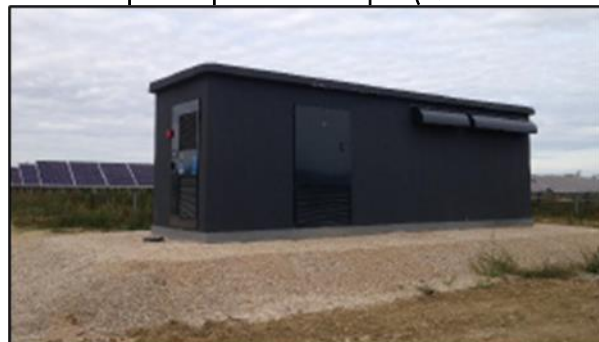
Illustration 17 : Exemple de poste électrique (livraison et transformation)
